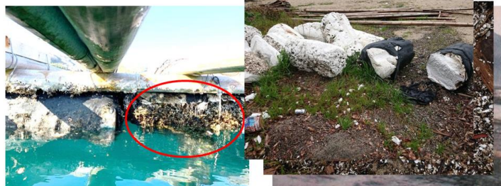
発砲フロート 右側は減耗し機能していない
